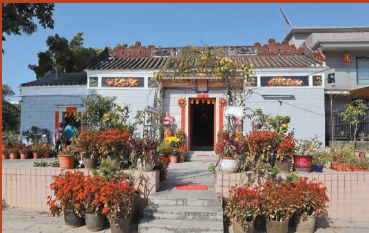
去年農曆年間，廟仍未修葺，屋頂呈現殘舊模樣，屋脊浮雕亦隱沒。
