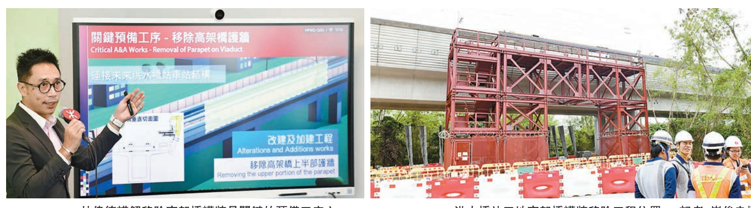
林偉德講解拆除高架橋護牆是關鍵的預備工序之一。 洪水橋站工地高架橋護牆拆除工程位置。 記者 崔俊良攝
