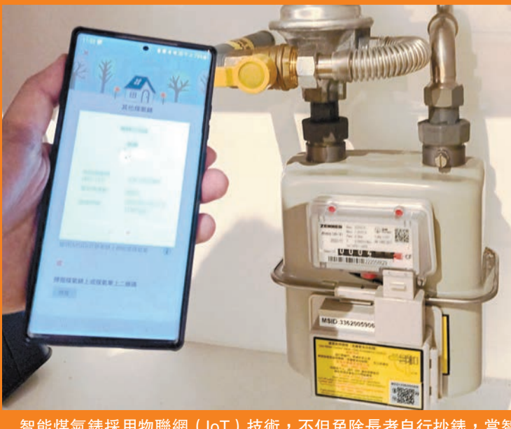
智能煤氣錶採用物聯網（IoT）技術，不但免除長者自行抄錶，當智能煤氣錶探測到家居有不正常的用量或洩漏，更會自動切斷供氣，進一步確保家居安全。
