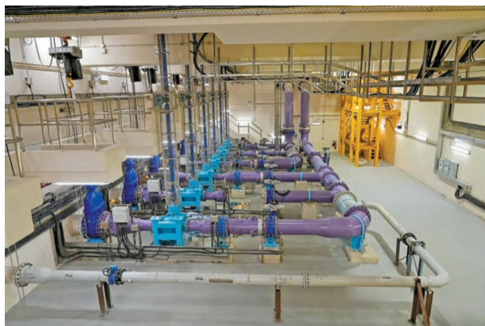
▲圖為再造水廠的泵房，會輸送已加入藍色食用色素的再造水，讓用戶可憑肉眼識別再造水與食水，以防止喉管被錯誤接駁或使用。
