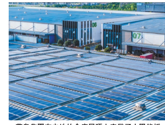
菜鳥集團在內地的倉庫屋頂上安裝了太陽能板，以支持倉庫的運營並減少電力成本。
