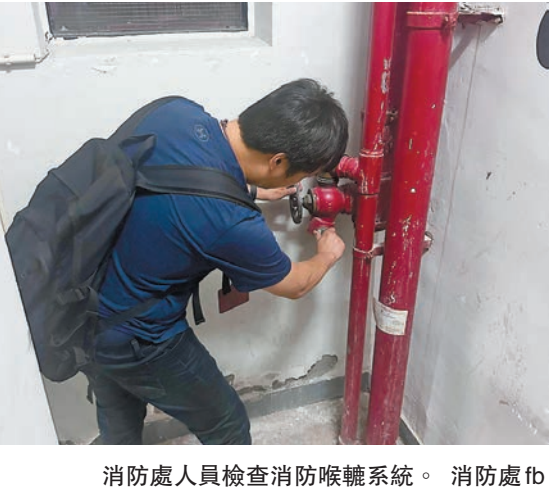
消防處人員檢查消防喉轆系統。 消防處fb
