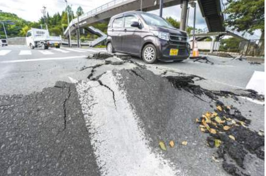
在地震發生時，香港一個15人旅行團正在熊本高速公路，因部分路段下陷而未能前行。圖為在熊本縣拍攝的受損路面。
