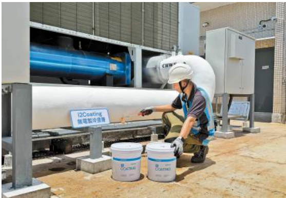
中電源動首次把香港初創公司i2Cool研發的專利被動式輻射降溫塗料應用於這次項目的供冷系統。
